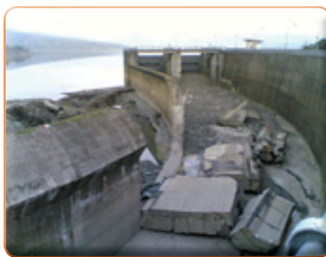
La parte del muro di sfioro che ha ceduto il 29 dicembre 2010
