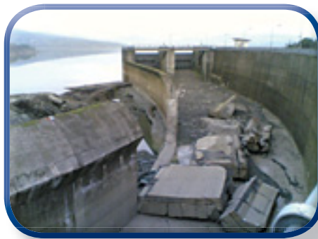
La PARETE DI SFIORO dell'invaso di MONTEDOGLIO dopo l'incidente di fine 2010
