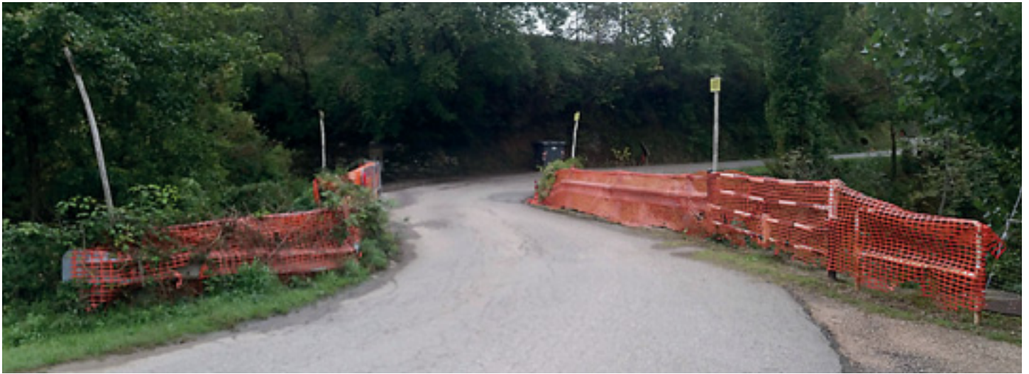
Le condizioni del ponte situato all'altezza della località Le Tovagliole
