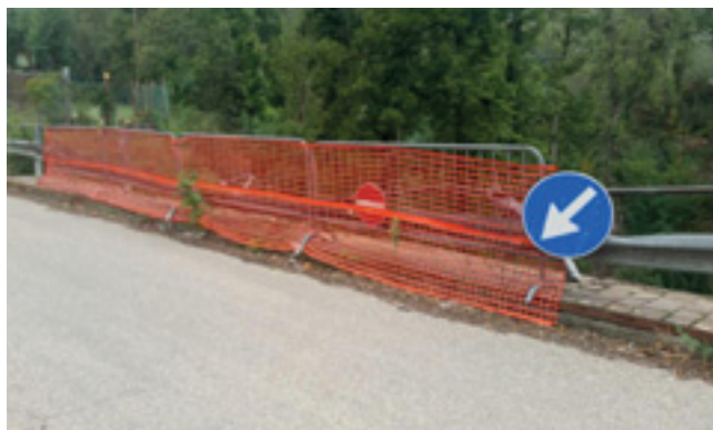
Particolare del ponte San Francesco transennato
